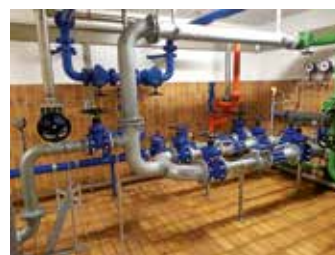
Rohrkeller Hochbehälter Itzinger Weg
