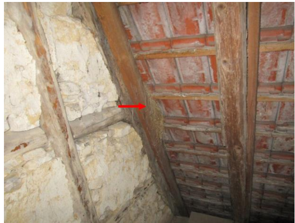
Abb. 7: Nistmaterial an Dachbalken im Wohngebäude
